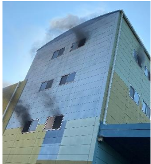
【火災による黒煙】
