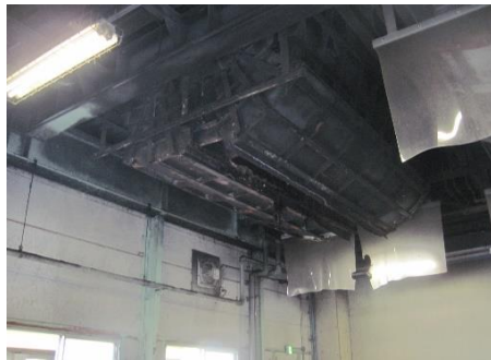
【可燃物を溜める場所（バンカ）の焼損状況】
