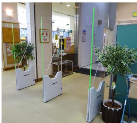
ICゲート設置
