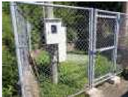
第1中継ポンプ場
