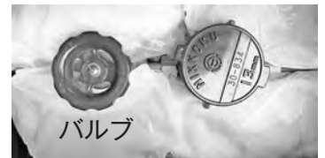
▲水道メーターボックス内
