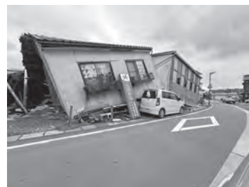
▲1階部分が崩れて車が挟まっている建物
